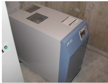
コンプレッサー
