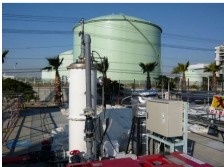
(Nhà máy phát điện) (Nhà máy sản xuất lương thực) loại bỏ hydrosulfuric
